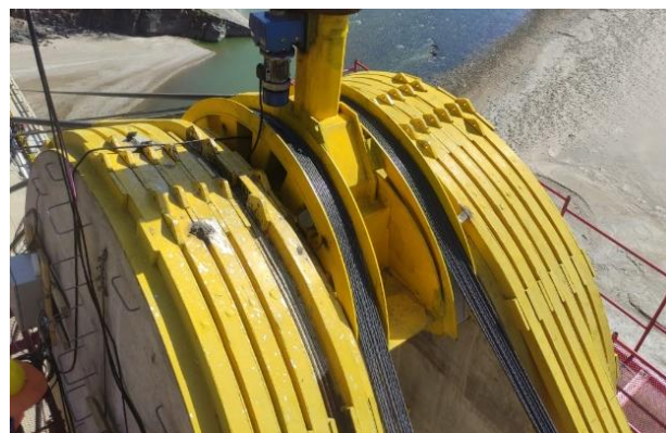
Figura 6. Cabeza de pila lado Santa Cruz, antes de la intervención.
