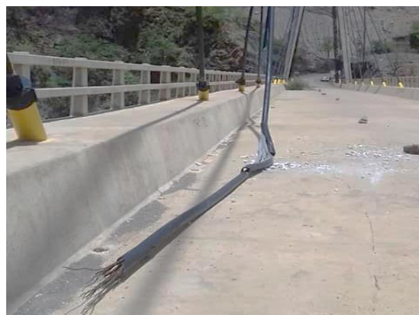
Figura 3. Rotura de tirante 5, lado sur, pilono Santa Cruz, ocurrido el año 2017.
