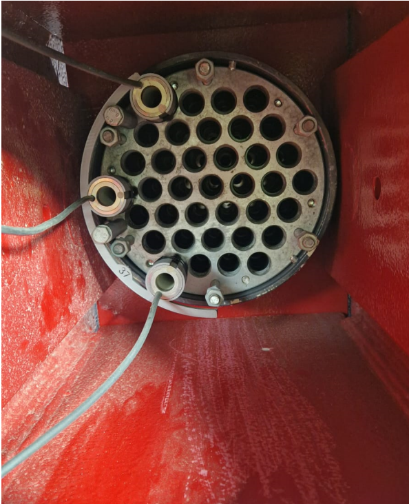
Figura 14. Sensores DYNA Force® instalados en un anclaje.
