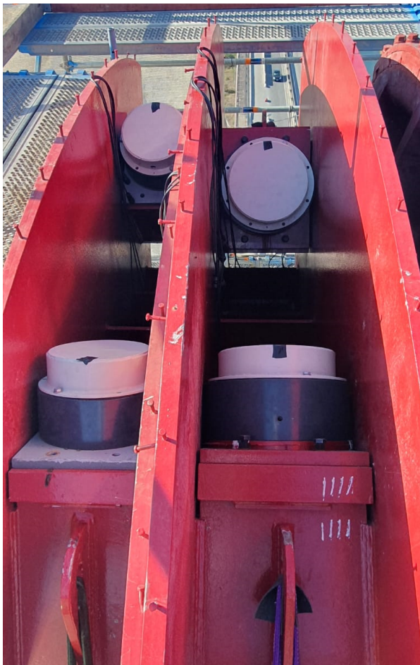
Figura 10. Anclajes fijos en la torre.
