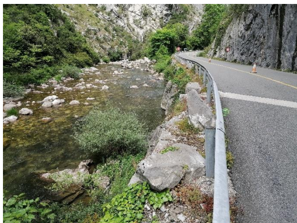
Figura 1. Estado inicial de la carretera.
