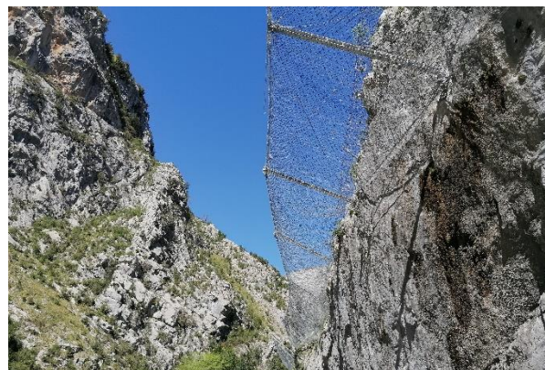
Figura 1. Protección ante desprendimientos.
