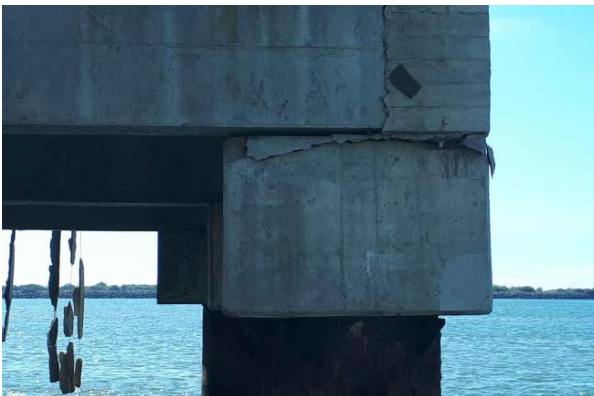
Figura 7. Superestructura desplazada lado tierra.
