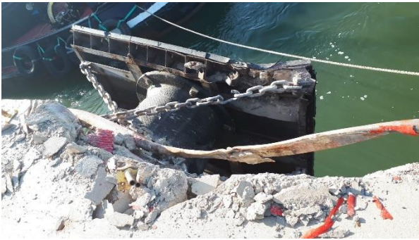
Figura 5. Vista de daños desde plataforma
