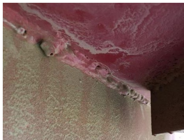
Figura 8. Poros e irregularidades en soldaduras
