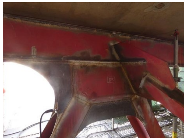
Figura 15. Refuerzo de nudo del cordón superior
