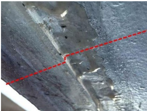
Figura 10. Cizallado inducido en el deslizamiento
