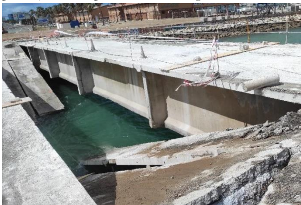
Figura 12. Colapso de las vigas 4 y 5
