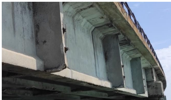
Figura 4. Vista de las riostras transversales y de los elementos de anclaje del pretensado transversal, sin protección y muy deteriorados.
