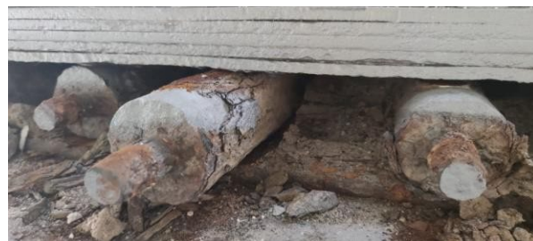
Figura 12. Deterioro de rodillos debido a la corrosión
