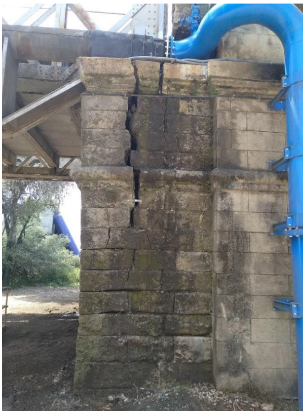
Figura 6. Grieta en paramento lateral de estribo norte debido al bloqueo de los apoyos
