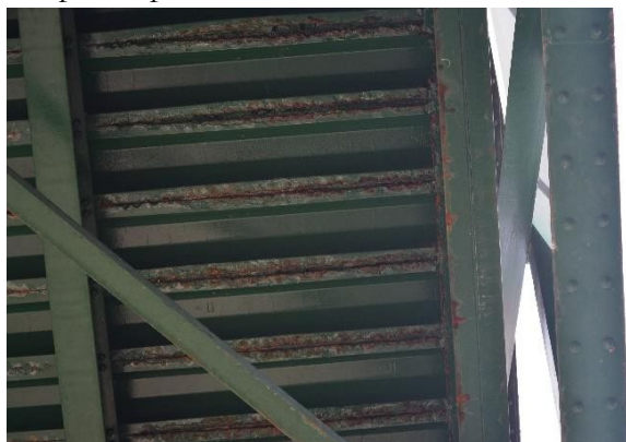
Figura 4. Corrosión generalizada en perfiles “omega”
