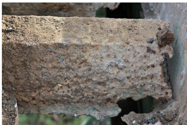
Figura 6. Vista de corrosión en perfiles “omega”
