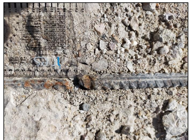
Figura 6. Corte de armadura pasiva por corrosión por picaduras
