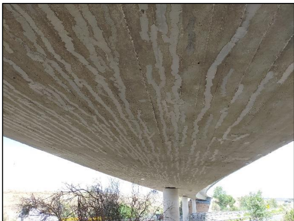
Figura 10. Vista de las fisuras selladas e inyectadas en la tabla inferior de un puente en Valladolid afectado por reacciones árido-álcali
