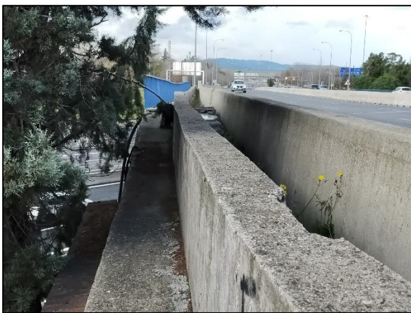
Figura 5. Deformación del tablero (ver la referencia de la barandilla azul)
