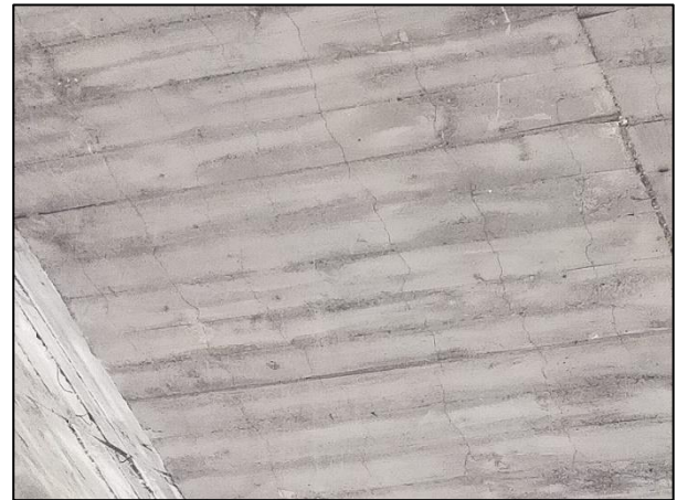
Figura 3. Fisuras longitudinales bajo tablero.
