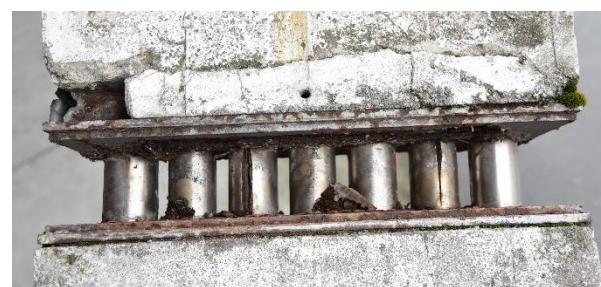
Figura 20. Estado rótula exterior.
