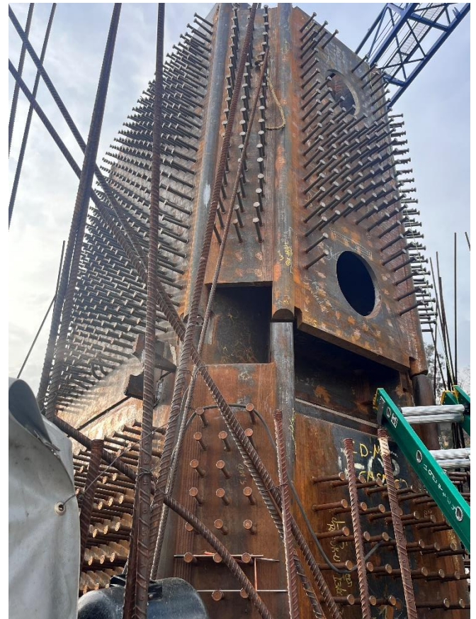
Figura 4. Armario en torre
