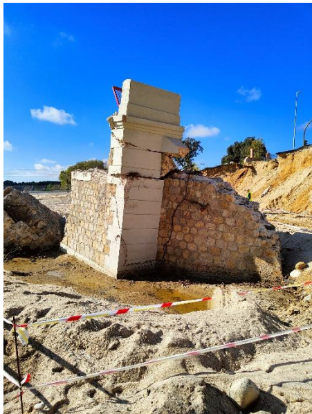
Figura 7. Vista parcial de la ruina del estribo norte.
