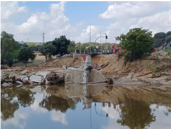
Figura 16. Vista de la erosión de la margen tras el estribo.
