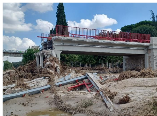
Figura 6. Vista del 5º vano tras la dana.
