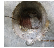
Figura 8. Caracterización fisuras en almas.
