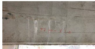
Figura 7. Fisuración longitudinal en vigas en V
