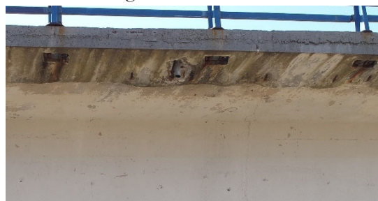
Figura 5 Deterioros en el voladizo
