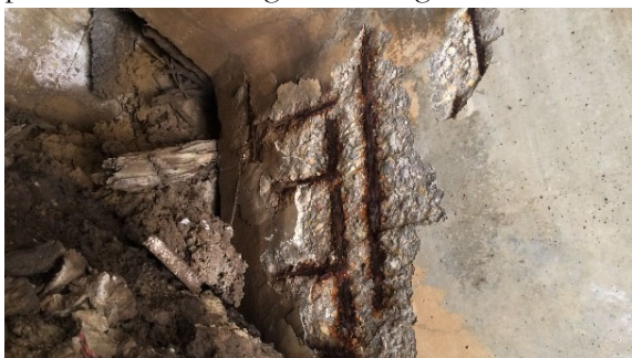
Figura 6. Degradación de las zonas de apoyo de las vigas
