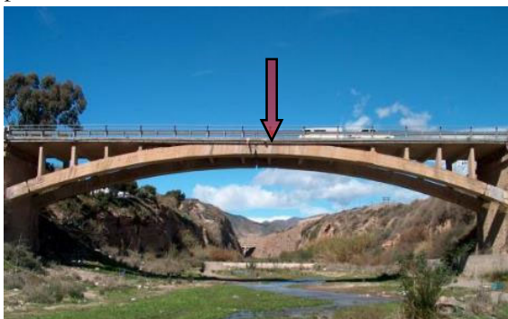
Figura 12. Deformación del centro de vano
