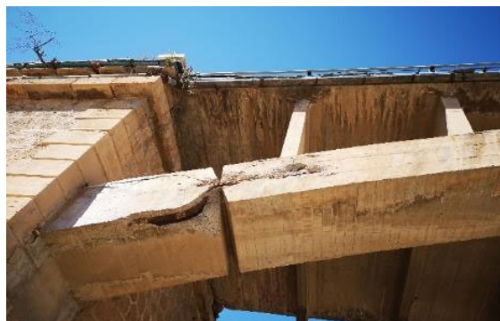
Figura 10. Perfiles metálicos vistos por estallido del recubrimiento de hormigón en zona de rotula de empotramiento.
