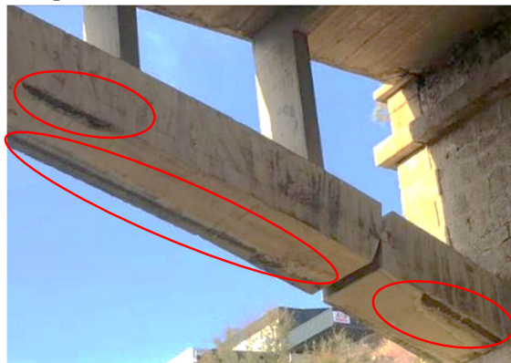
Figura 11. Perfiles metálicos vistos por estallido del recubrimiento de hormigón
