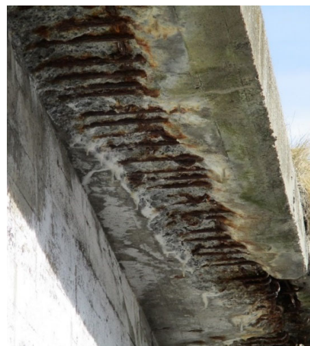
Figura 14 Vista de la cara inferior del voladizo
