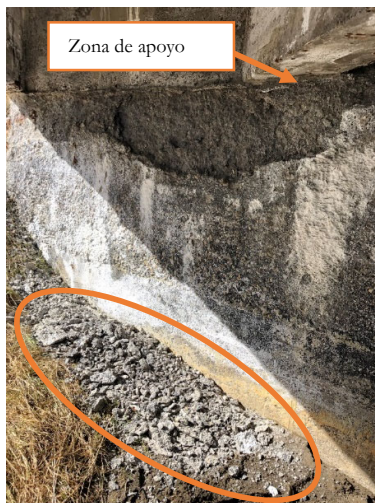
Figura 11 Degradación de los paramentos de hormigón
