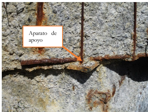
Figura 12 Deficientes condiciones de apoyo
