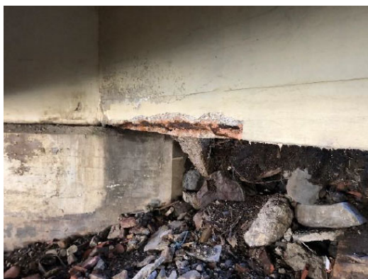
Figura 21 Armadura activa al descubierto en avanzado estado de oxidación
