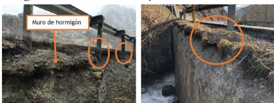
Figura 29 Deficiente anclaje de barrera bionda sobre muro de hormigón fuertemente erosionado
