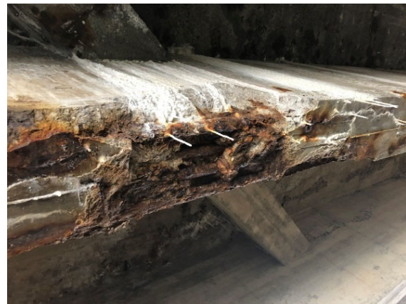
Figura 13 Desconchones con armadura vista en avanzado estado de oxidación en los nervios del tablero
