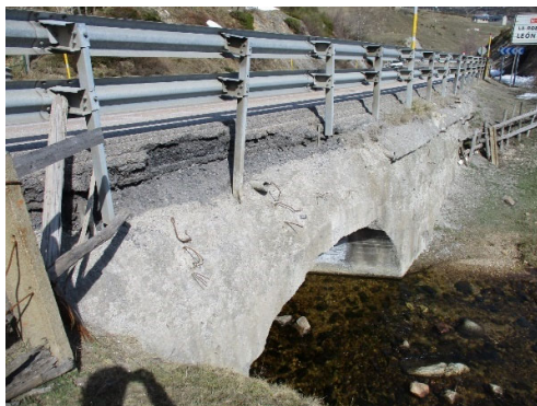
Figura 3 Degradación de paramentos de hormigón
