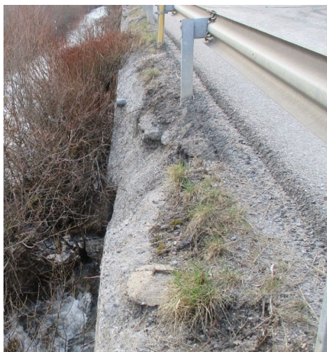
Figura 28 Deficiente anclaje de la barrera bionda
