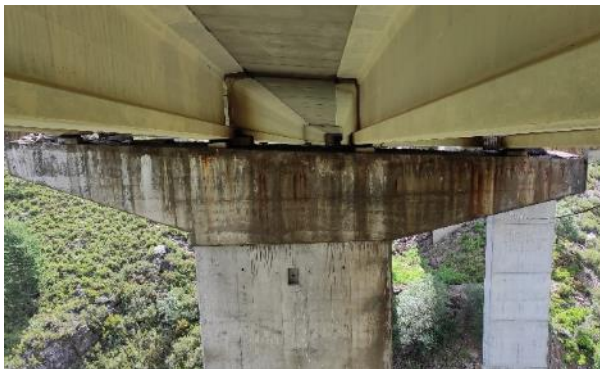
Figura 5. Humedades, eflorescencias, lajaciones y signos de corrosión en las armaduras de la pila P-3.
