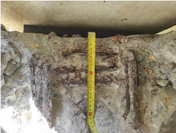
Figura 22. Calas en el dintel para determinar la posición de la armadura transversal y vertical.
