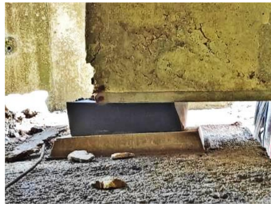
Figura 8. Viga reptada sobre el apoyo, sin longitud de entrega efectiva (Pila P-3, lado Benavente).
