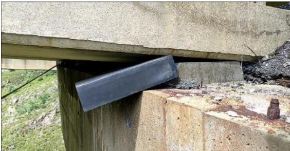
Figura 2. Situación del aparato de apoyo que dio lugar al escalón en la calzada.
