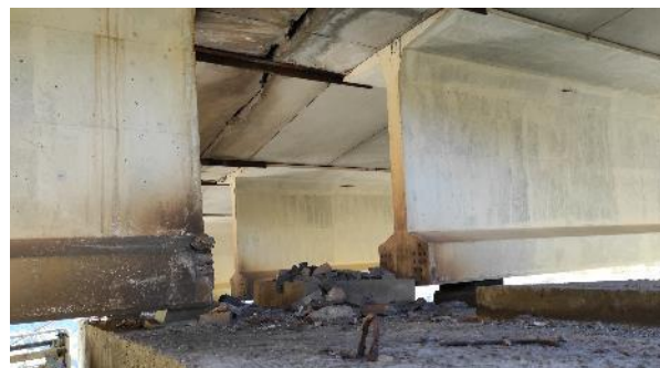
Figura 12. Vigas sobre pila central. La diferencia en las entregas de las vigas denota el desplazamiento relativo entre tablero y pila.
