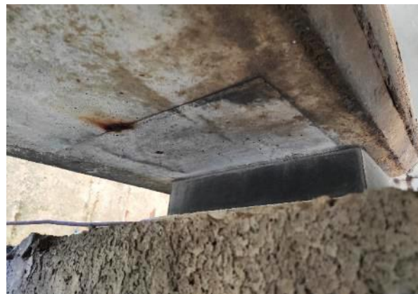
Figura 9. Apoyo sin desplazamiento, pero viga reptada como indica la sombra de la posición original (Pila P-3, lado Orense).
