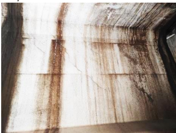
Figura 18. Fisuración diagonal en alma marcada por humedades. Viga 3, E-1. Sentido Benavente.
