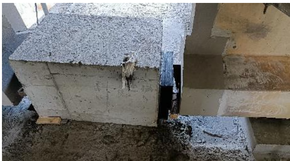
Figura 14. Nuevo tope longitudinal en pila central para limitar el desplazamiento relativo del tablero.
