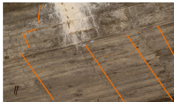
Figura 14. Detalle de fisuras transversales en vano V6
