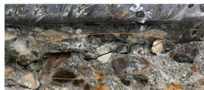
Figura 22. Rotura de áridos y delaminación en zona de grietas
