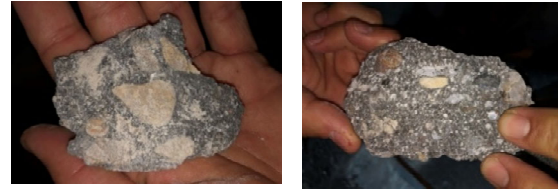
Figura 11. Detalle de lajas de hormigón picado, con presencia de manchas blanquecinas y humedad interna ocluida, factores compatibles con problemas de reacción árido-álcali.
