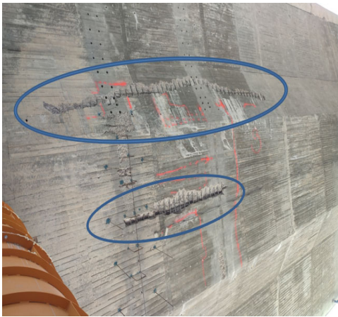
Figura 20. Vista general de las grietas detectadas durante la operación de saneado del vano V6.
