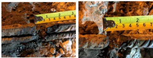
Figura 10. Detalle de armaduras seccionadas
