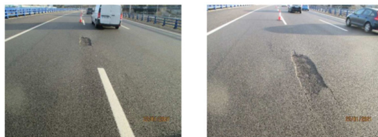
Figura 7. Detalle del bache aparecido en plataforma tras un episodio de nieve y frío significativo.
