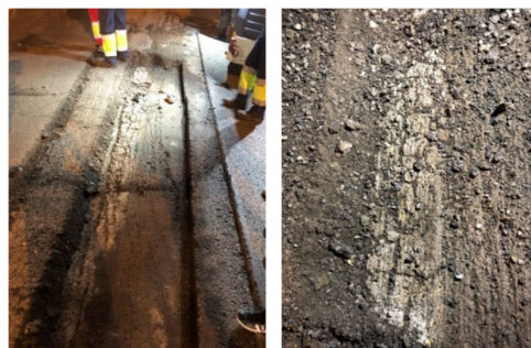
Figura 8. Degradación y agrietamiento excesivo superficial del hormigón de la cara superior de losa.
