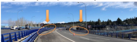
Figura 6. Vista general de plataforma. Apreciación clara de la deformación del tablero en el vano V6.
