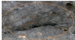
Figura 21. Delaminación sistemática del hormigón en zona de grieta
