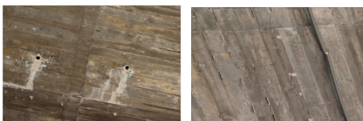
Figura 13. Humedades en cara inferior de losa coincidentes con los tubos de sujeción de los encofrados y fisuras/grietas longitudinales en la cara inferior del tablero.
