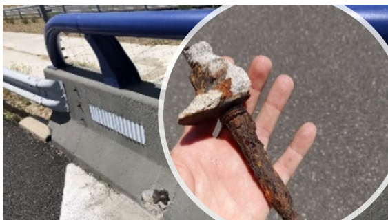
Figura 11. Pretil de hormigón prefabricado y perno extraído tras la rotura y casi caída de un módulo.
