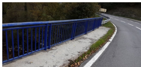
Figura 7. Sistema sin marcado CE: tipo “baranda”.
