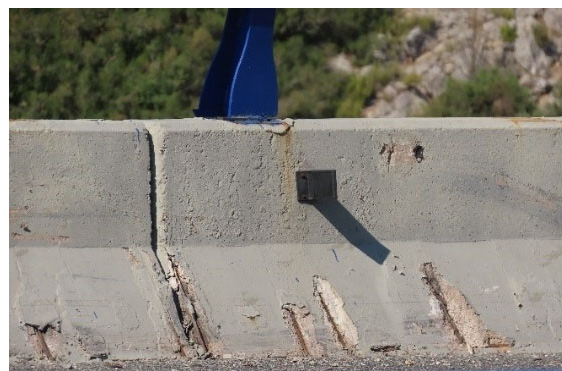
Figura 13. Lajaciones y corrosión en las armaduras.
