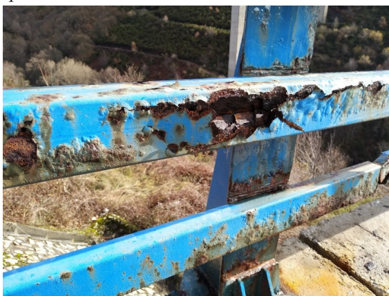
Figura 12. Pretil afectado por corrosión.
