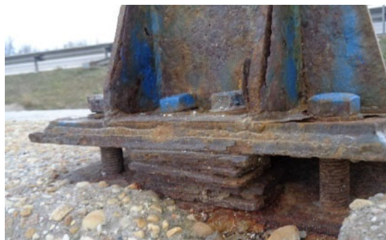
Figura 10. Mal ajuste geométrico entre poste de pretil y placa de anclaje.
