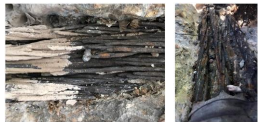
Figura 21. Inspección de tendón de pretensado en punto alto de trazado. Relleno inadecuado del tendón, con corrosión y rotura de torones.
