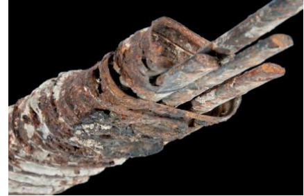
Figura 6. Detalle del estado del pretensado tras el accidente. Claros defectos en la inyección de vainas [2].
