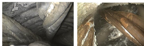
Figura 25. Tendones de pretensado en interior de bloque con ausencia de lechada y con indicios de corrosión.
