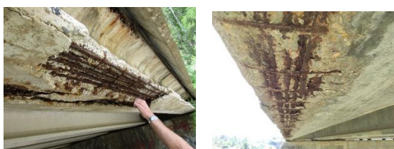
Figura 17. Grave afección al pretensado de las vigas laterales por afección directa de agua con fundentes sobre los paramentos de hormigón
