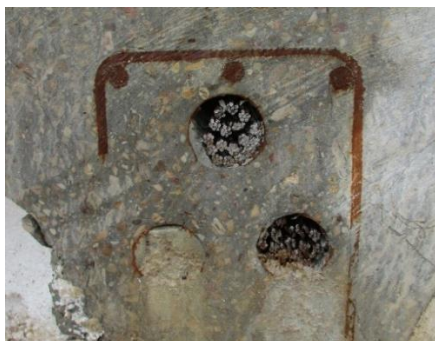
Figura 20. Ejemplo de tablero de puente seccionado en donde se diferencian diferentes defectos de inyección de los tendones del pretensado.
