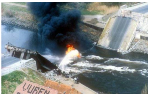
Figura 9. Vista general del puente Malle tras el colapso [1].
