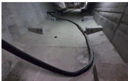
Figura 15. Imagen del cajón interior en donde se puede observar el cable roto
