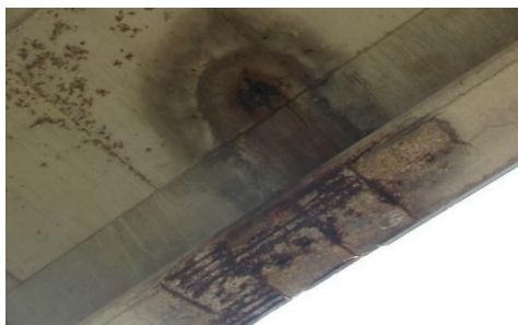
Figura 16. Ausencia de bajante en sumidero de tablero, produciendo la circulación del agua por los paramentos de losa y viga, produciendo graves daños en el pretensado de la viga
