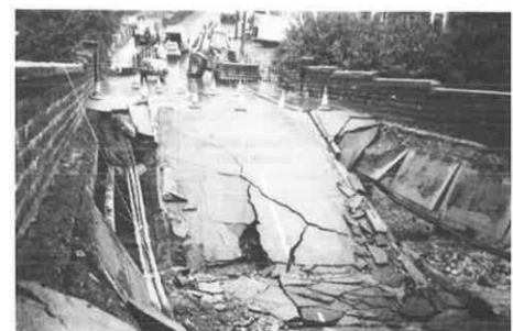
Figura 8. Imagen tras colapso del puente
