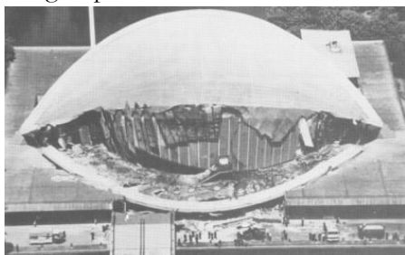
Figura 5. Vista general del palacio de Congresos tras su colapso [2].
