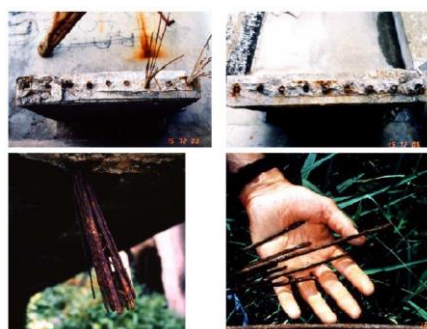
Figura 10. Detalle de la rotura de cordones de postesado descubiertos tras el colapso del puente [1].
