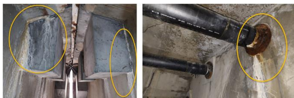
Figura 24. Indicios de circulación de agua en los bloques de anclaje del sistema de pretensado no adherente.
