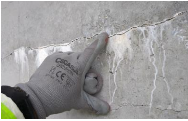
Figura 22. Eflorescencias en paramento de hormigón como consecuencia del agua filtrada desde el interior de la vaina al exterior.
