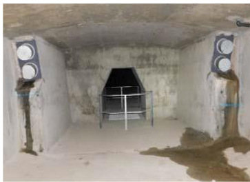
Figura 23. Humedades en interior de cajón como consecuencia del agua que circula desde la plataforma al interior a través de los tendones.
