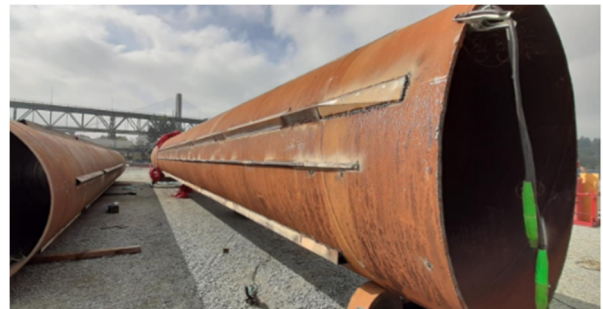
Figura 5. Varillas de referencia (Telltale rods) con su protección.
