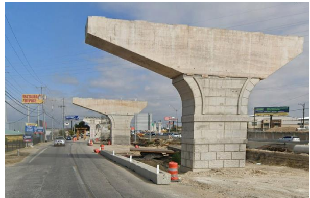
Figura 11. Vista de varias pilas martillo consecutivas con excentricidad elevada.
