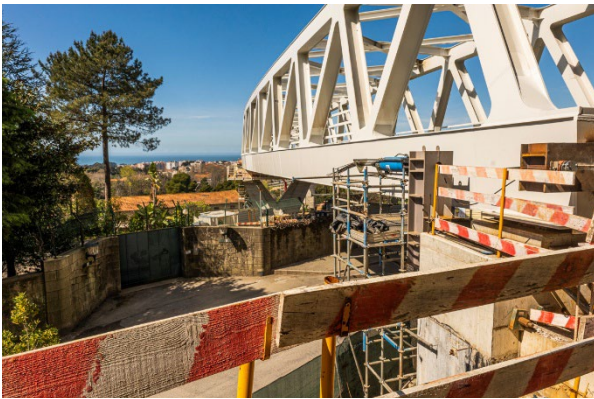
Figura 9 Detalle de sistema de tiro y bastidor de apoyo de cordones.
