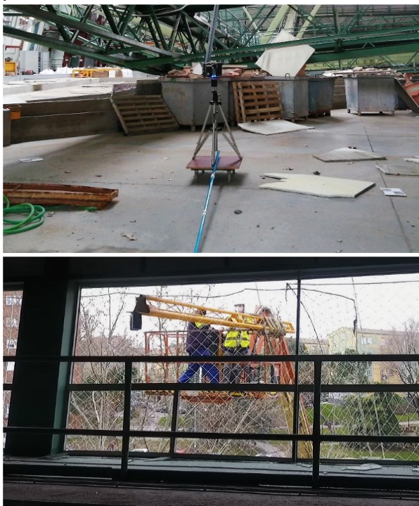
Figura 6. Estacionamiento del LIDAR desde el exterior (carro con pértiga y plataforma elevada).
