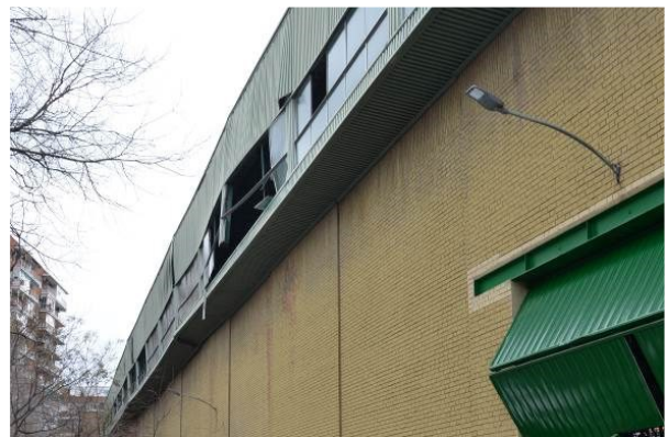
Figura 14. Expulsión de ventanales perimetrales por el colapso.
