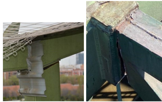
Figura 24. Roturas en uniones soldadas de penetración total con preparación de bordes.
