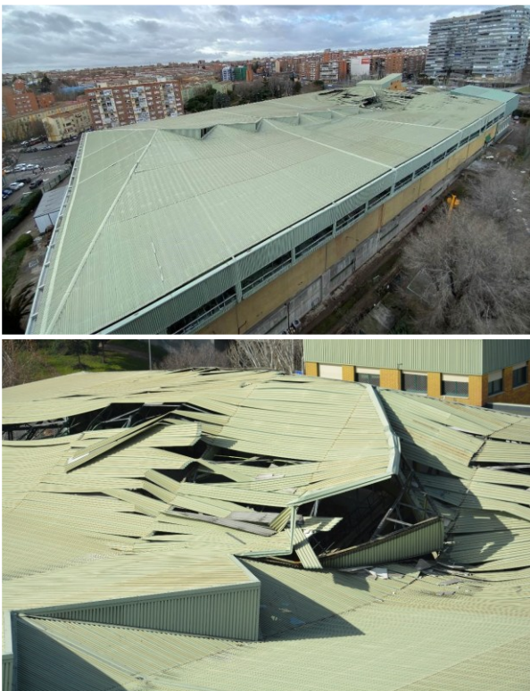
Figura 10. Fotografía de la cubierta de la nave tras el colapso, tomada desde un edificio próximo
