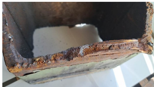
Figura 21. Huellas de decohesión en el lado agudo de la diagonal tubular en R14.
