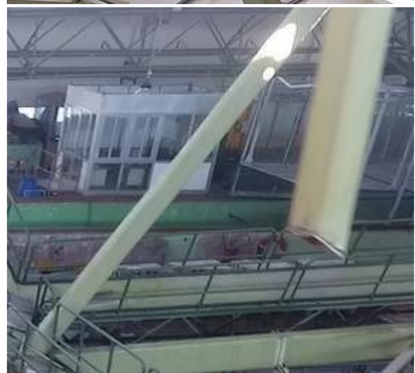
Figura 11. Rotura de uniones en las celosías principales
