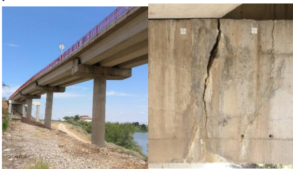
Figura 2. Viaducto de Quinto. Vista de la grieta en el dintel de la pila con dianas para el seguimiento topográfico.
