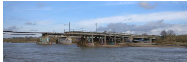
Figura 25. Puentes ferroviario y viario sobre la Tordera después del temporal.
