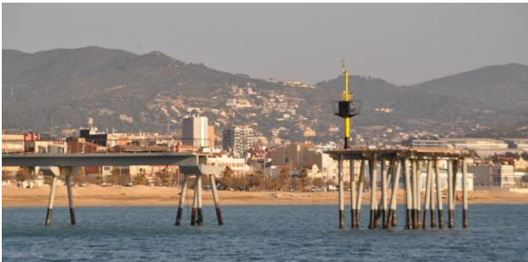
Figura 23. Pont del Petroli en Badalona. Estado actual después del temporal Gloria.
