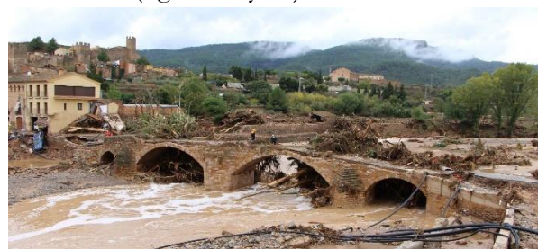
Figura 12. Vista del Pont Vell de Montblanc después de la avenida del Francolí en noviembre de 2019.
