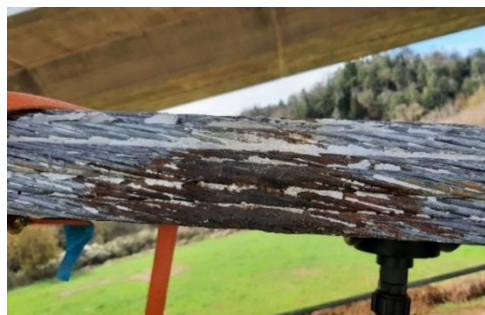
Figura 3. Viaducto de Osormort. Imagen de la corrosión en los tirantes del viaducto.
