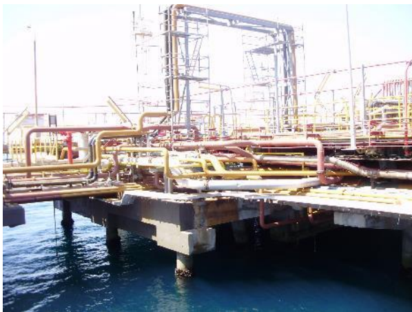
Figura 2. Estado del rack previo a las actuaciones.
