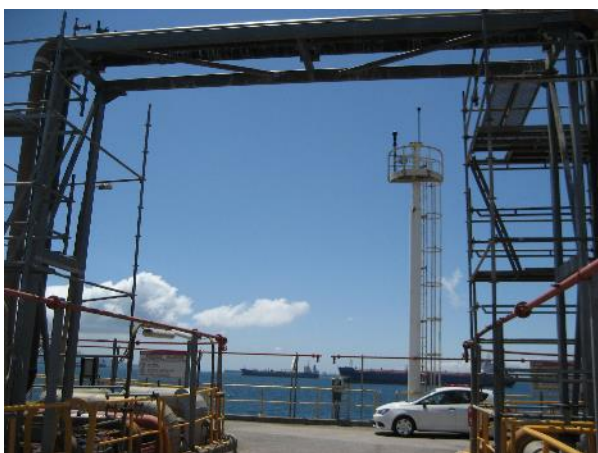
Figura 3. Estado del rack previo a las actuaciones.
