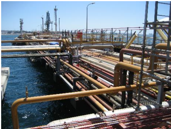
Figura 1. Estado del rack previo a las actuaciones.
