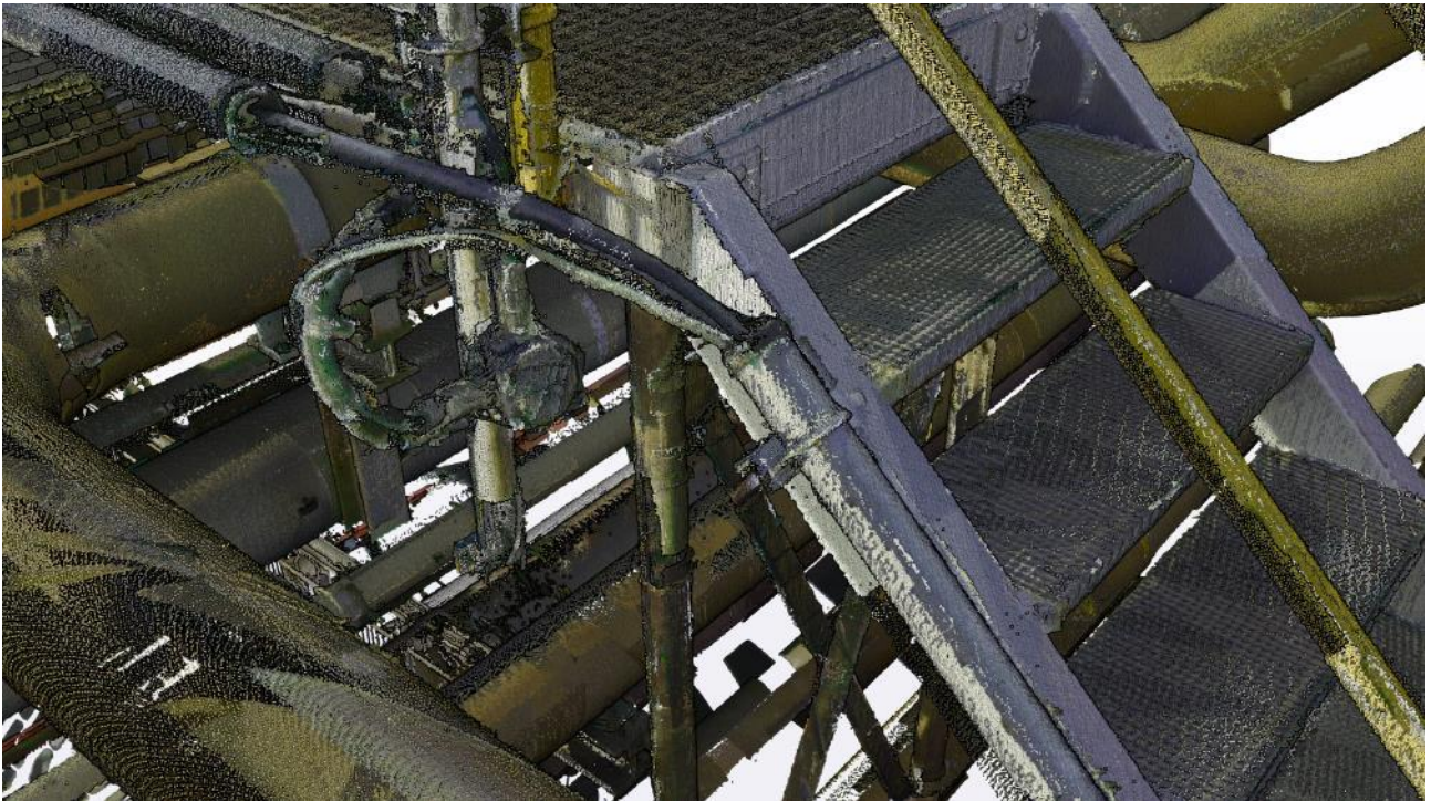
Figura 9. Vista general de la nube de puntos. Zoom cercano. Las texturas sobre las tuberías son más visibles y empiezan a ser percibidas como traslúcidas.
