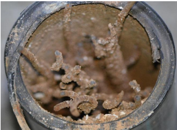
Figura 5. Vista frontal del tendón roto, con algunas roturas ‘frescas’ en los alambres
