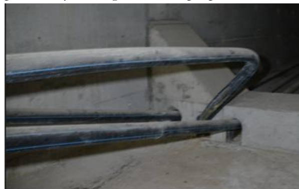
Figura 3. Deformación remanente encontrada en el tendón colapsado a su paso por del desviador.
