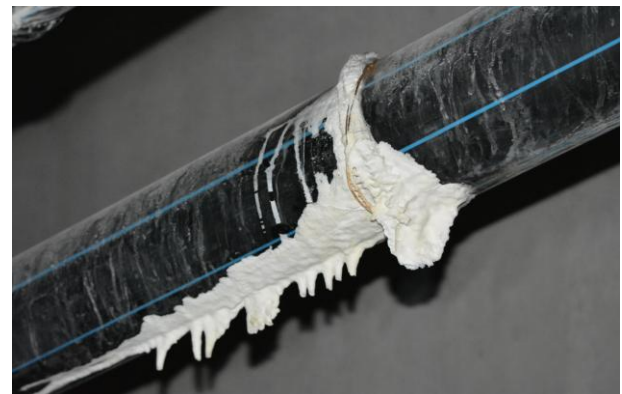
Figura 7. Presencia de estalactitas en un tendón, en el entorno del empalme de la vaina
