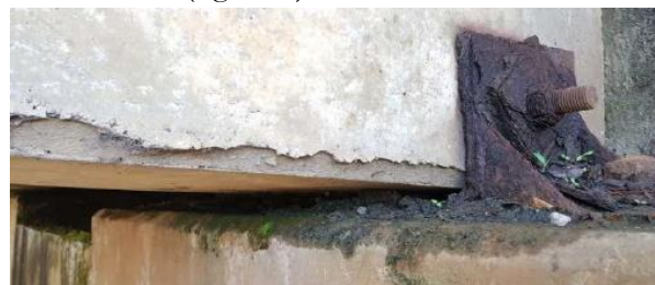
Figura 6. Armadura vista en cara inferior de vigas
