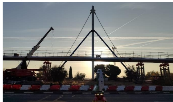
Figura 18. Pilono con arriostramiento y cables de retenida.
