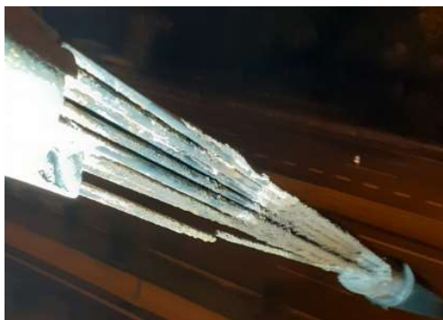
Figura 4. Cable T6S con la rotura de vaina y posterior reconstrucción temporal
