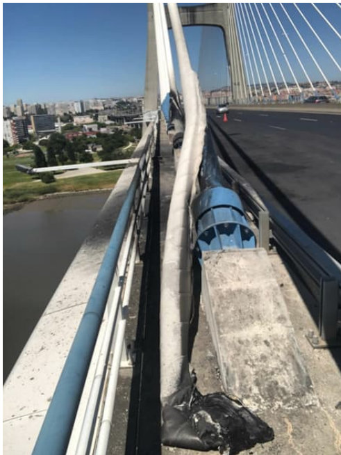
Figura 2. Daños en el HNC22D.
