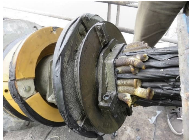
Figura 3. Daños en el amortiguador y los cordones.
