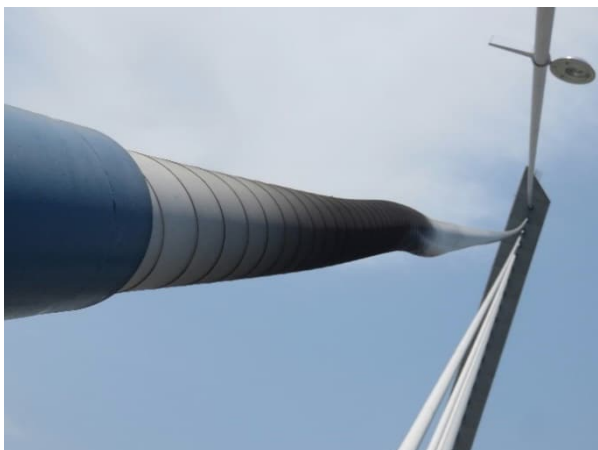
Figura 5. Daños en la vaina HNC23D.
