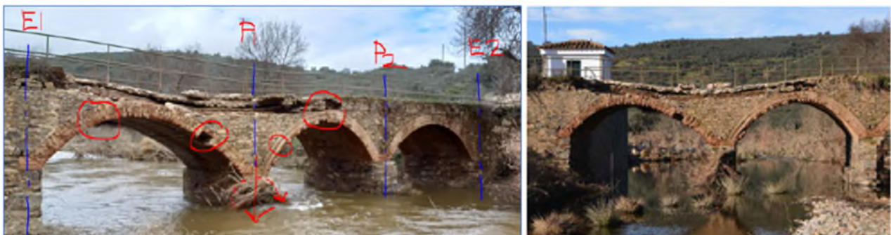
Figura 2. Alzado general del puente desde aguas arriba, después de producirse la avenida.
