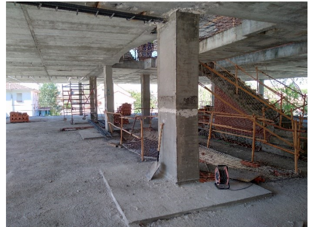
Figura 9. Estado final de refuerzo frente a punzonamiento.
