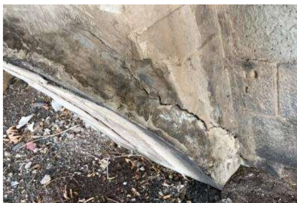
Figura 8. Grietas en arranque de arcos
