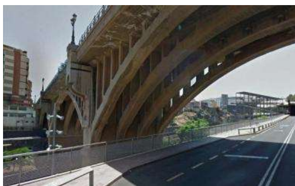
Figura 7. Humedades en vuelos laterales
