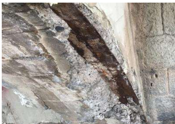
Figura 9. Desprendimiento de masa de los arcos, dejando a la vista las cerchas interiores
