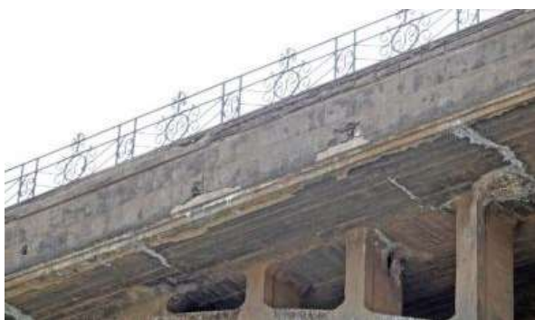
Figura 6. Desprendimiento del material que constituye los pretilos
