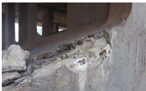
Figura 10. Presencia de material de relleno inapropiado, procedente de reparaciones anteriores, no adherido a la estructura
