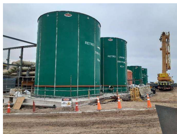
Figura 14. Depósitos de almacenamiento-Retrolavado - UF.
