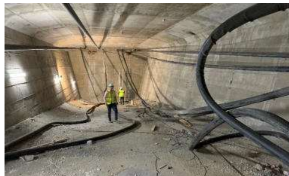
Figura 6. Interior del tablero de una de las estructuras
