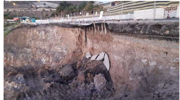
Figura 4. Espacio vacío provocado por el derrumbamiento, por donde debería discurrir la calzada rehabilitada
