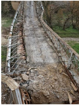
Figura 21. Disposición del vano colapsado.
