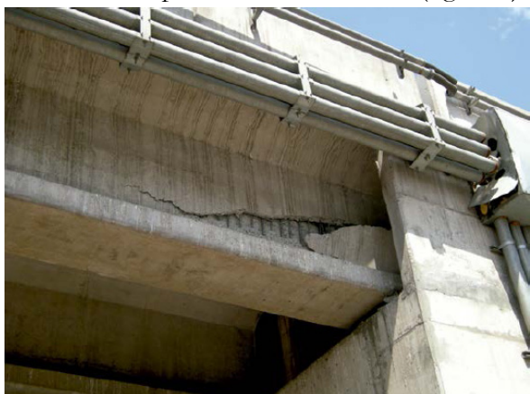
Figura 4. Fallo del alma de una viga por ausencia de diafragmas (terremoto de Concepción -27 de febrero de 2010-) [1]
