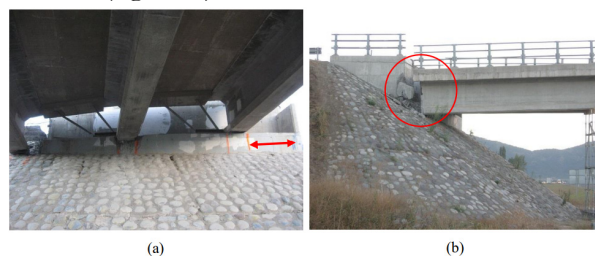
Figura 3. Falta de arriostramiento eficaz de los extremos de las vigas [2].
