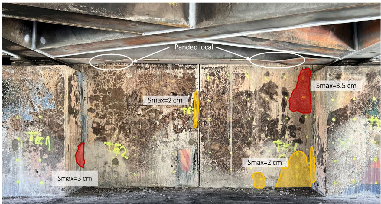
Figura 4. Vista general del área afectada por el incendio. “s max ” es el desconchado máximo del hormigón medido en la zona analizada.
