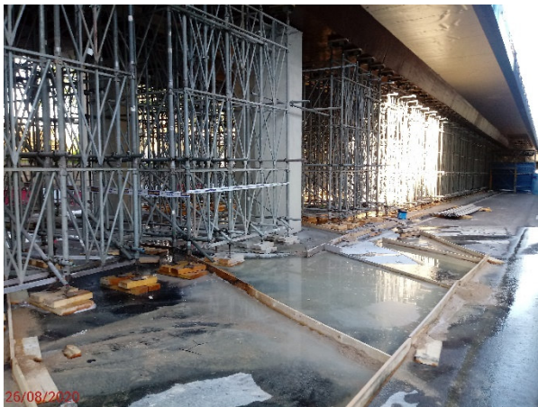
Figura 10. Sistema de canalización y decantación.
