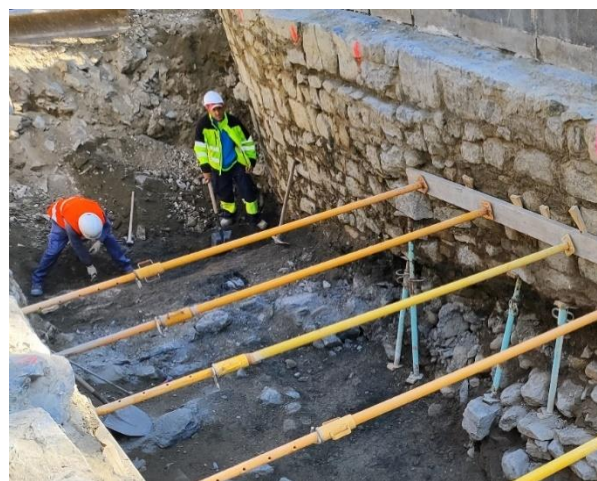
Figura 21. Vista del estado del trasdós de la bóveda 1.
