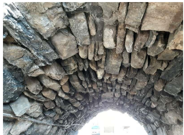
Figura 8. Pérdida de material de juntas y exfoliaciones en bóveda 1.
