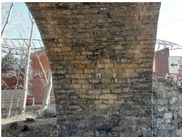
Figura 6. Eflorescencias en la bóveda 2.
