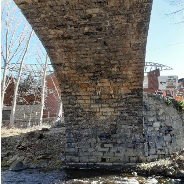
Figura 5. Presencia de humedades en la bóveda 2.
