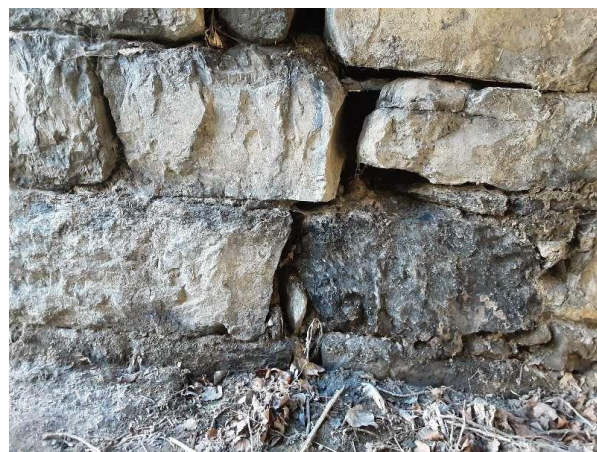
Figura 12. Arenización en la parte inferior de pila 1.
