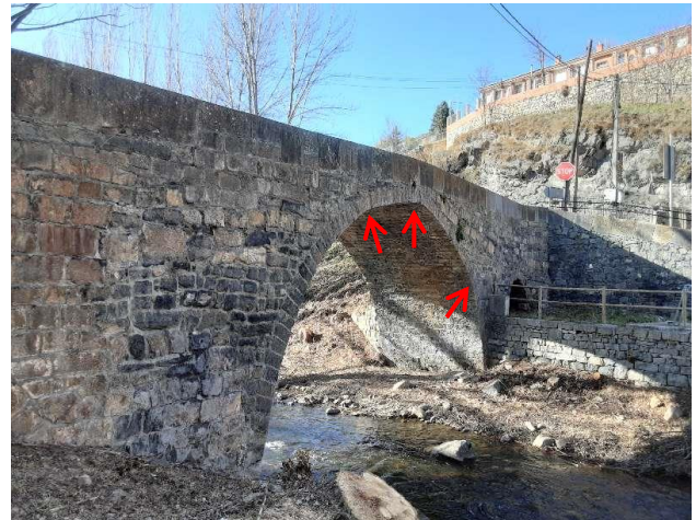
Figura 7. Deformaciones en bóveda 2. Puntos de formación de rótulas
