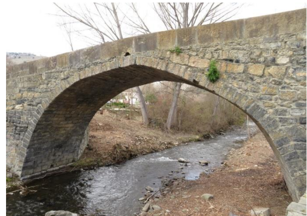
Figura 2. Bóveda 2, principal, desde margen izquierda, lado aguas abajo. Obsérvese la deformada.
