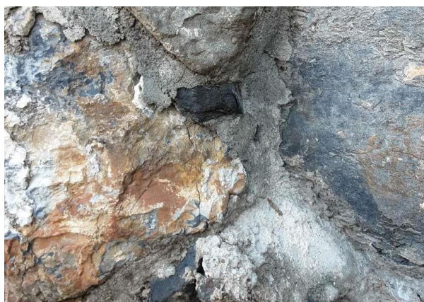
Figura 9. Fisuras verticales en el estribo 1.
