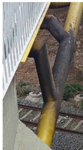
Figura 17. Vista parcial de los elementos afectados por el incendio
