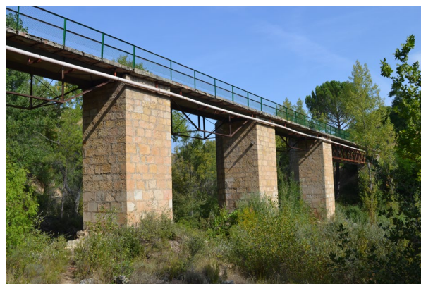
Figura 1. Pasarela existente en estado semirruinoso
