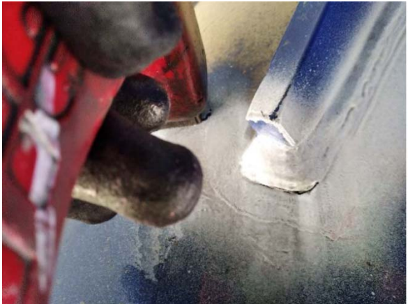
Figura 16. Falta de fusión en soldadura
