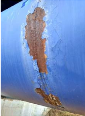
Figura 14. Degradación de la pintura
