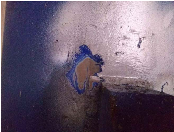
Figura 15. Defectos superficiales de laminación
