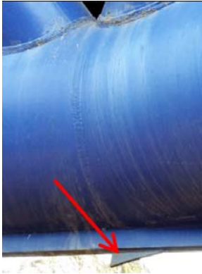
Figura 13. Restos de chapas de montaje
