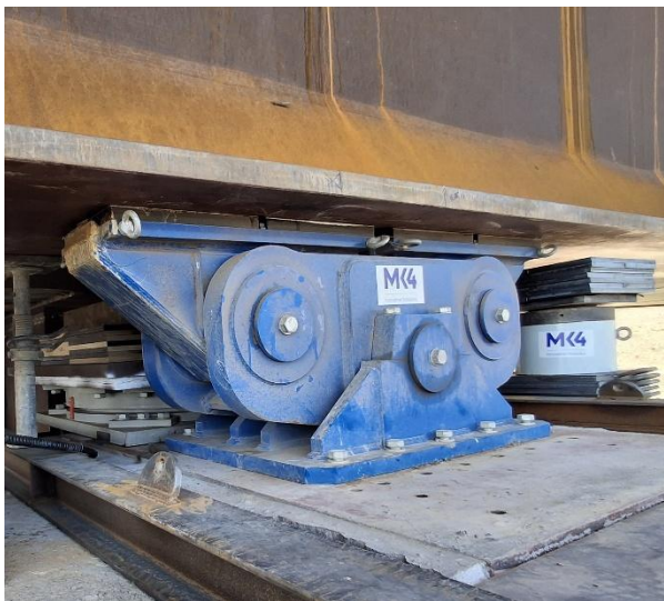
Figura 3. Balancín tri-axial Viaducto de Lucainena.
