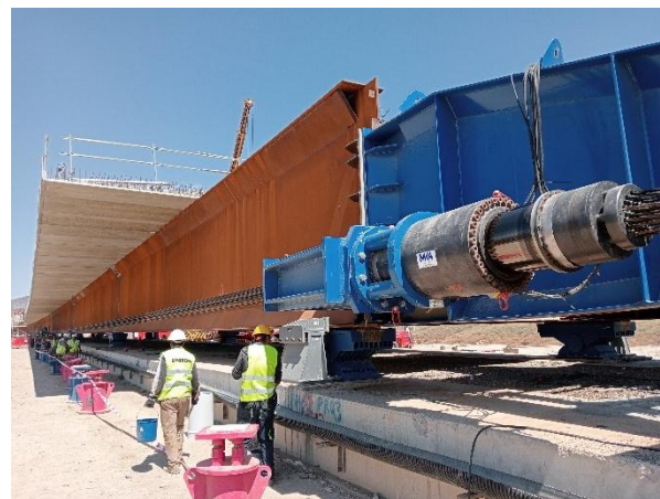
Figura 9. Equipos hidráulicos de empuje.
