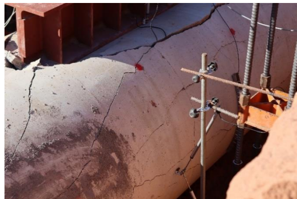
Figura 5. Fallo estructural de la tubería en RC-3.0.
