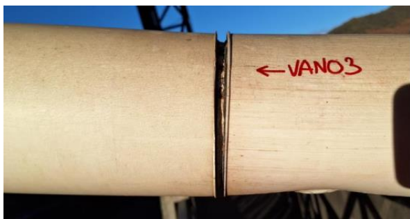
Figura 7. Apertura de soldadura.
