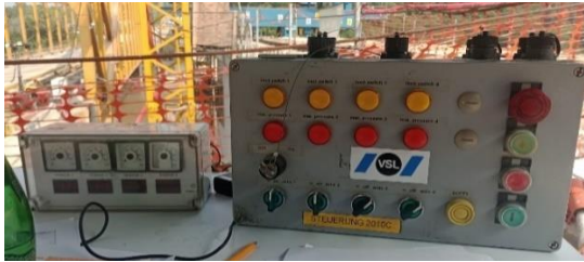
Figura 14. Panel de control de los cilindros hidráulicos de descenso.
