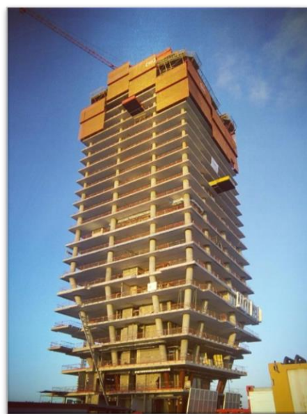
Figura 9. Desvíos de columnas en CFC.
