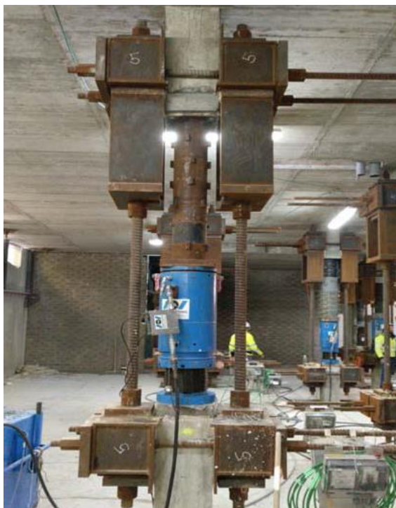
Figura 3 Sistema de soportes (sistema de barras), gato y discos descenso “Palma”
