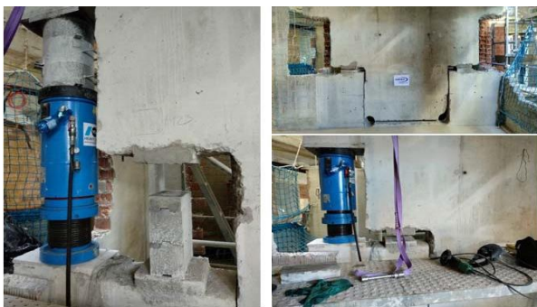
Figura 6 Detalles del sistema de descenso y guiado en núcleo “Barcelona”
